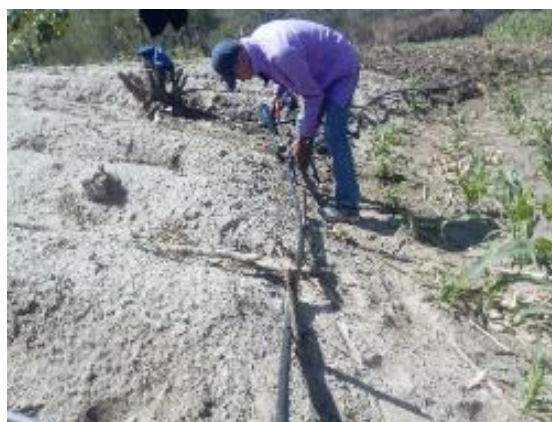
Ilustración 32 Instalación de riego por goteo, Chitomax. Fuente: EPS CECI 2018
