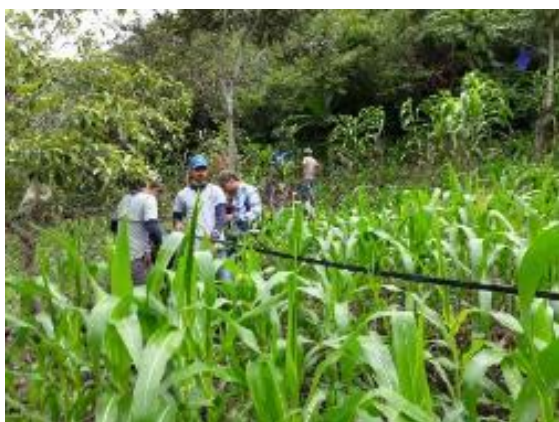
Ilustración 29 Instalación de riego por goteo en parcela de maíz, Río Negro Fuente: EPS CECI 2018
