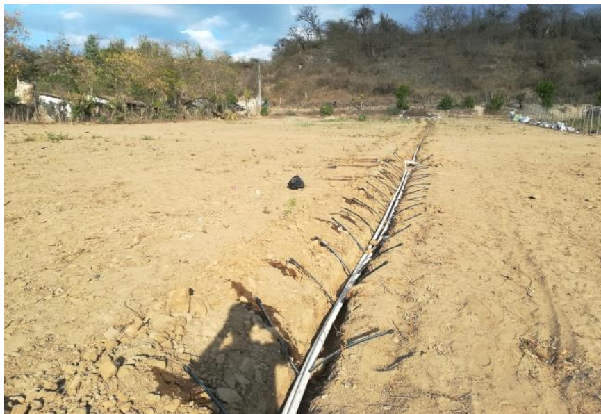
Figura 42A. Prueba de los manifold
