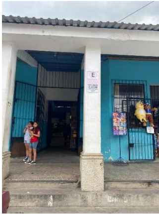
Figura 95. Ingreso peatonal a Mercado, inexistencia de rampa.
