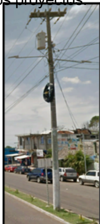
Figura 100. Iluminación pública existente en el casco urbano de Chiquimulilla. Fuente: Google Earth, 2024.
