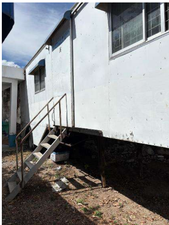
Furgón sin energía eléctrica
