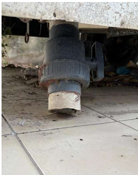
Drenaje quebrado del furgón
