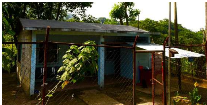
Imagen 17: Techo impermeabilizado del centro comunitario, San Miguel Pochuta, Chimaltenango.
