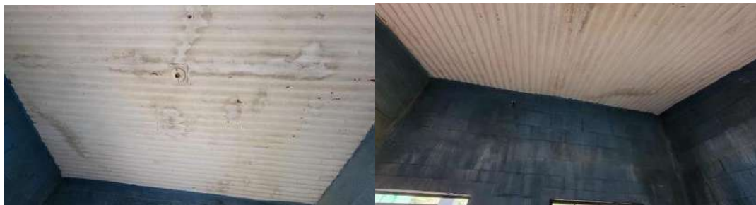
Imagen 11: Marcas de humedad resultado de las múltiples filtraciones en el centro comunitario, San Miguel Pochuta, Chimaltenango.
