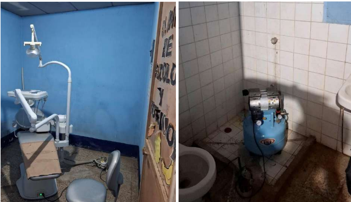
Fotografías 10 y 11. Estado del compresor y la unidad dental en las antiguas instalaciones del Centro de Salud, fecha: 24 de febrero de 2025.
