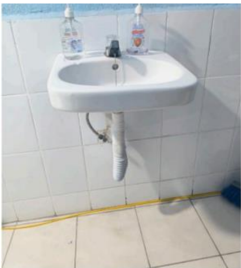
Fotografía No 14. Resultado de la mejora del lavamanos
