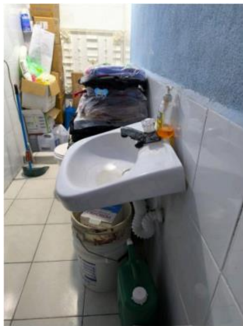
Fotografía No 13. Estado inicial de la infraestructura del sanitario
