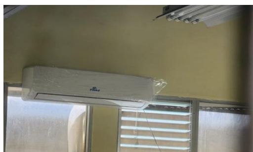
Fotografía 15. Aire acondicionado instalado en la clínica EPS.
