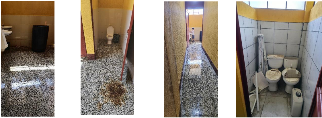
Imagen 1: Baños de la escuela Bella Vista antes de ser remodelados
