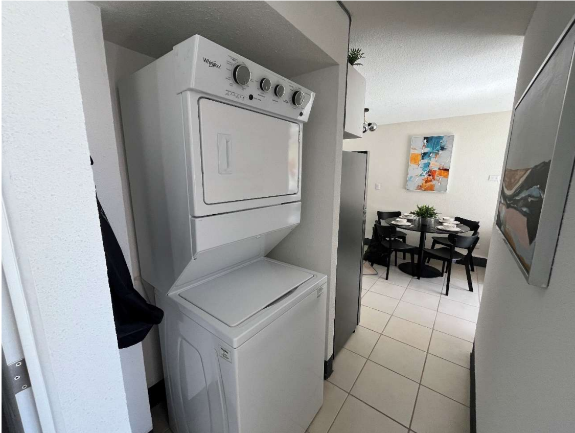
Fuente: fotografía propia, lavandería expuesta en pasillo, diciembre de 2025
