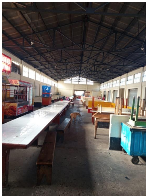
Figura 4. Deterioro del mercado en el segundo nivel y cubierta liviana para reducir peso sobre el 1er nivel.
