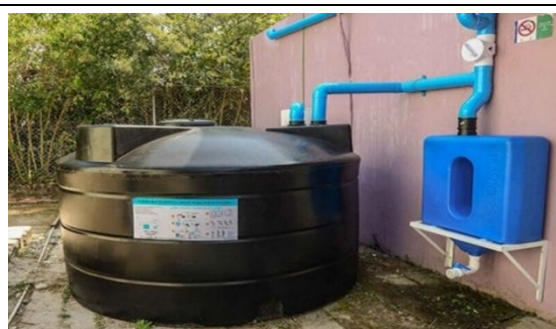
Figura 81. Captación agua pluvial
