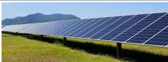
Figura 87. Sección de paneles solares
