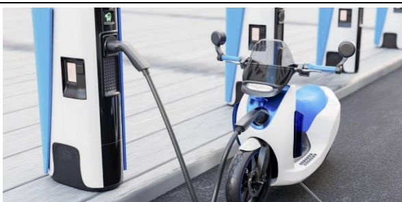
Figura 119. Cargadores para motos eléctricas
