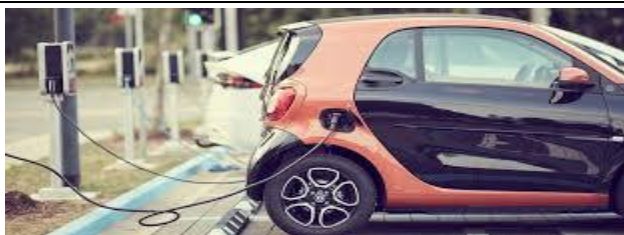
Figura 122. Parqueo carros eléctricos
