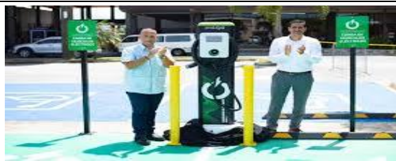
Figura 123. Cargadores para carro eléctrico
