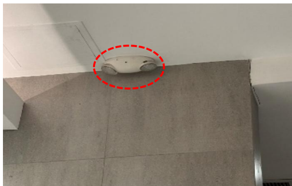
Figura 32. Luz de emergencia
