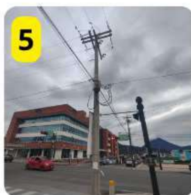
Poste de baja tensión
