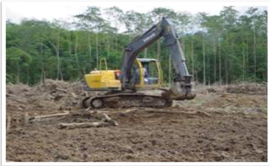
Figura 20. Uso de excavadora en limpieza de sitio para una plantación de palma africana.
