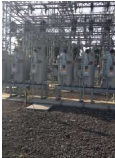
Figura 12. Medición campo magnético salida circuitos 13,8 kV
