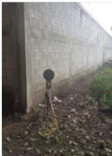
Figura 14. Medición campo magnético colindancia 2 subestación El Milagro
