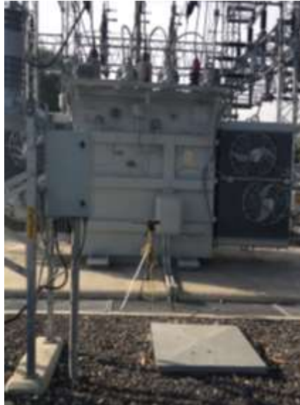
Figura 11. Medición campo eléctrico barra 13,8 kV
