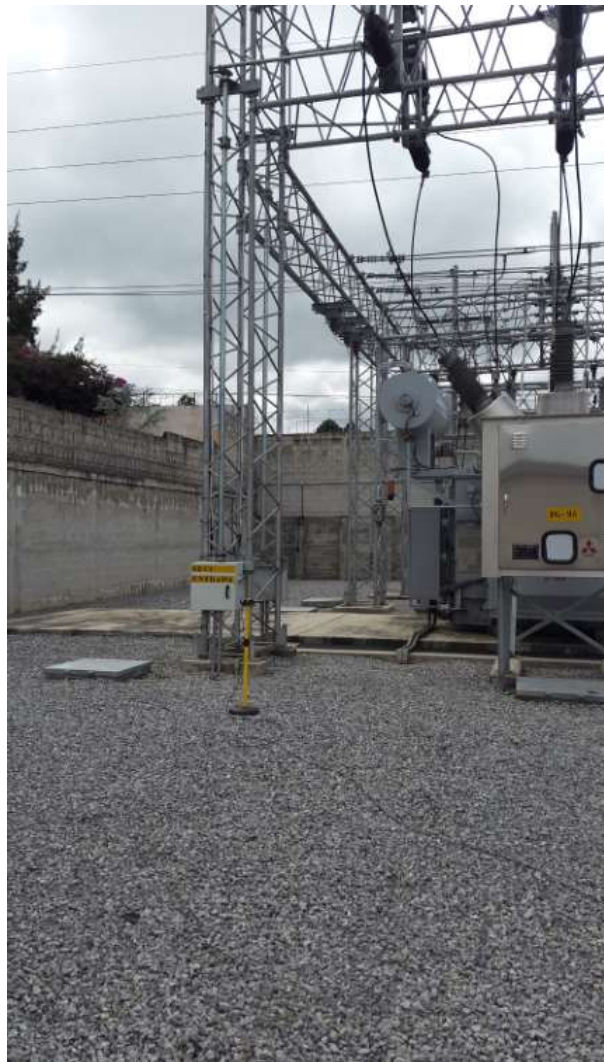
Figura 20. Medición campo eléctrico entrada de línea 69 kV
