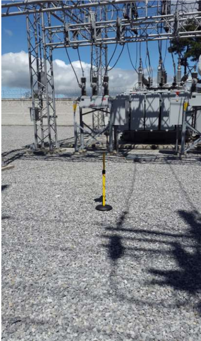
Figura 24. Medición campo eléctrico salida circuitos 13,8 kV
