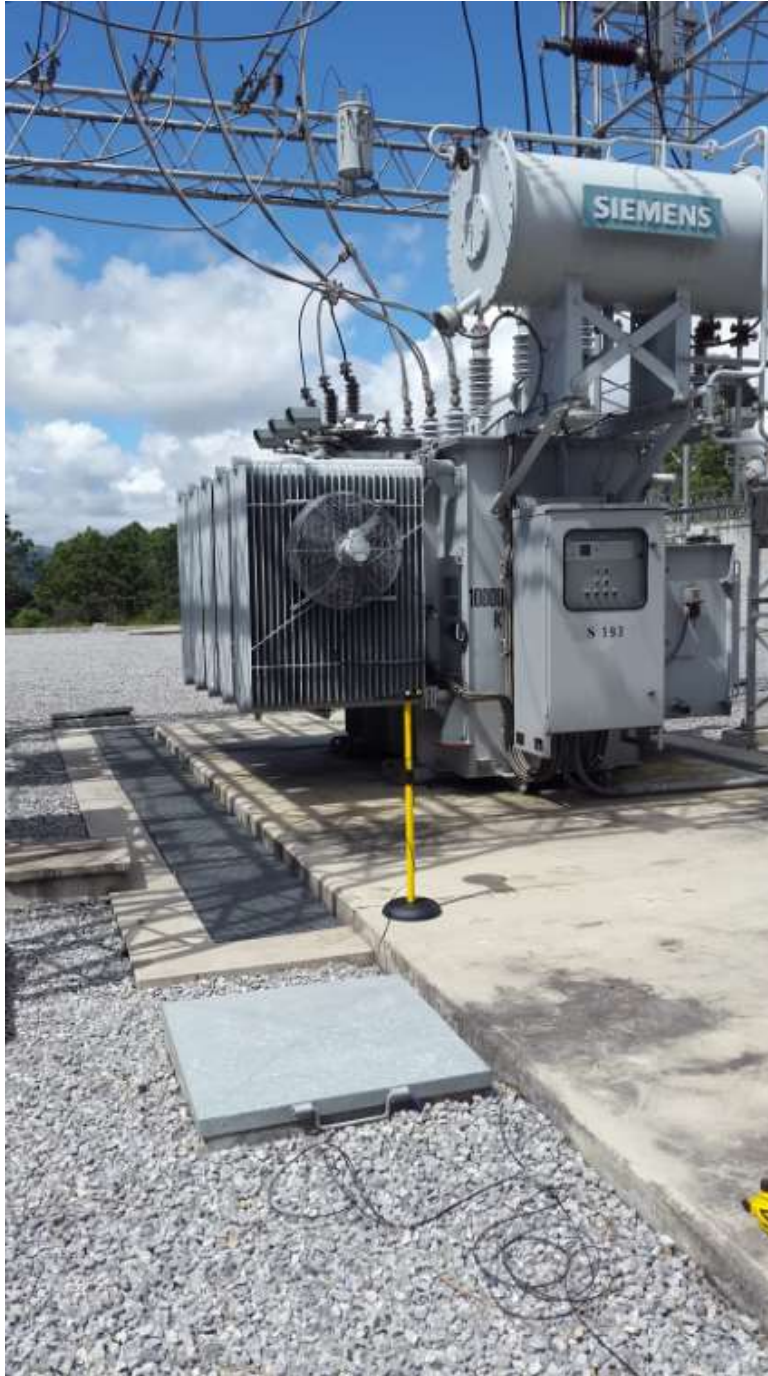
Figura 22. Medición campo eléctrico barra de 13,8 kV
