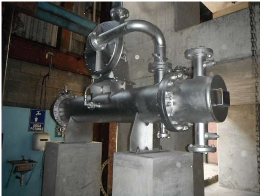
Figura 20. Vista del gland condenser situado sobre su base
