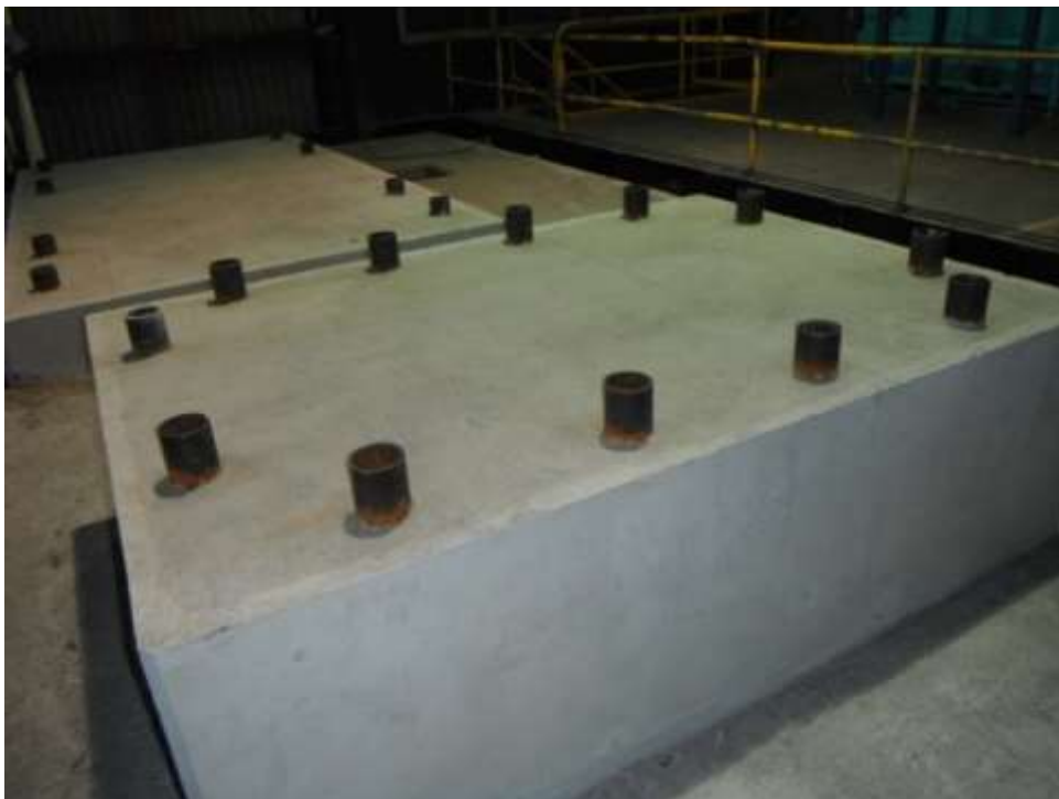
Figura 8. Vista de la base del reductor y generador, respectivamente
