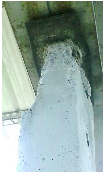
Figura 12. Falla de columna a compresión
