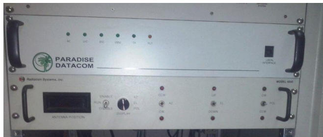
Figura 12. Tablero interno de control
