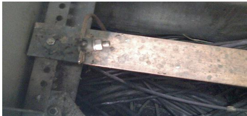
Figura 108. Barra equipotencial del tablero “MC Interconexión 2”
