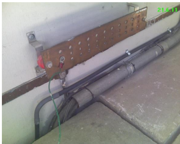
Figura 41. Barra equipotencial de la caseta “Siquinalá”
