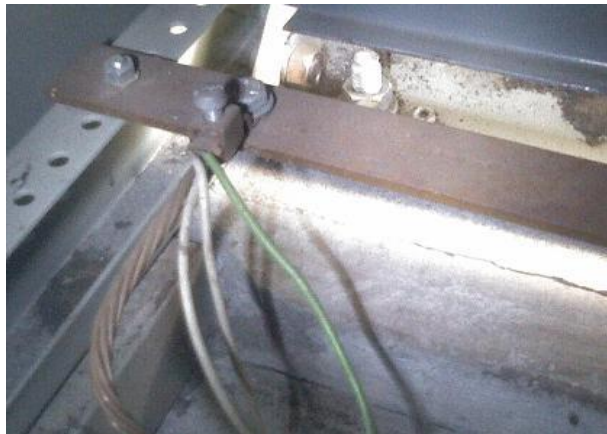
Figura 91. Barra equipotencial del tablero “PM Aguacapa”
