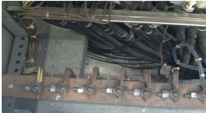
Figura 89. Barra equipotencial del tablero “BZ TCAE”
