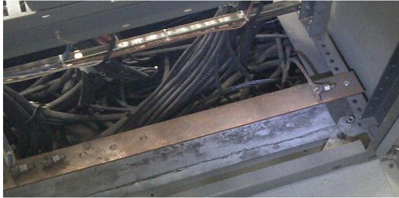
Figura 97. Barra equipotencial del tablero “BZ Interconexión 1”
