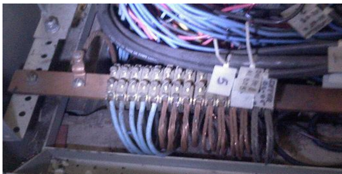
Figura 94. Barra equipotencial del tablero “BZ Enlace”
