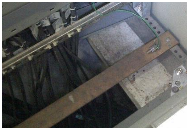
Figura 109. Barra equipotencial del tablero “MC TCAE”
