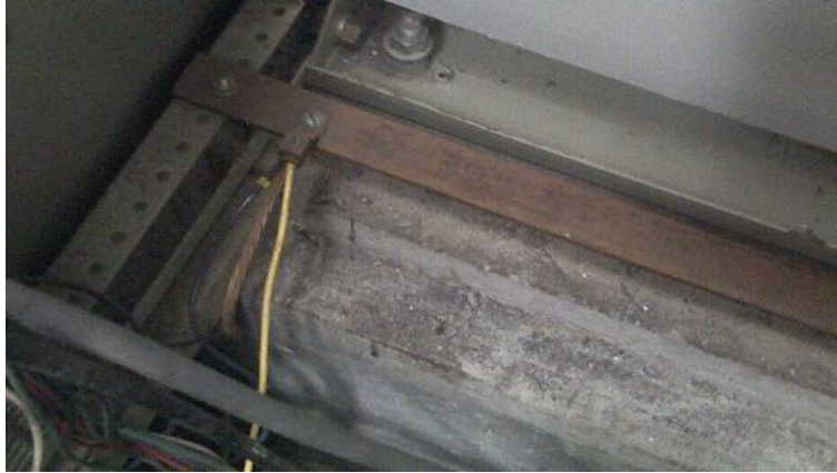
Figura 96. Barra equipotencial del tablero “PM Interconexión 1”
