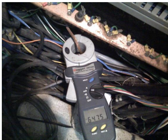
Figura 71. Barra equipotencial de tablero “Interruptor enlace 69 kV”
