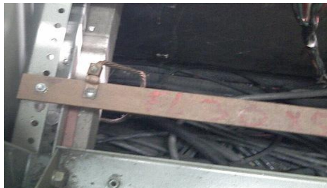
Figura 105. Barra equipotencial del tablero “MC Interconexión 1”
