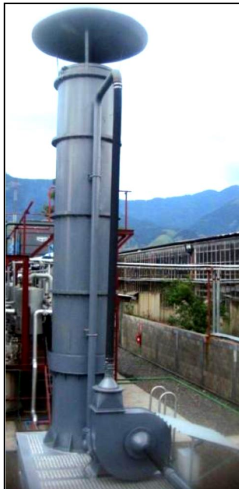
Figura 5. Depurador de emisiones de azufre (Scrubber Sulfinite. Lo-Cat)
