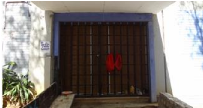
Figura 58. Salida de emergencia lateral del edificio cerrada
