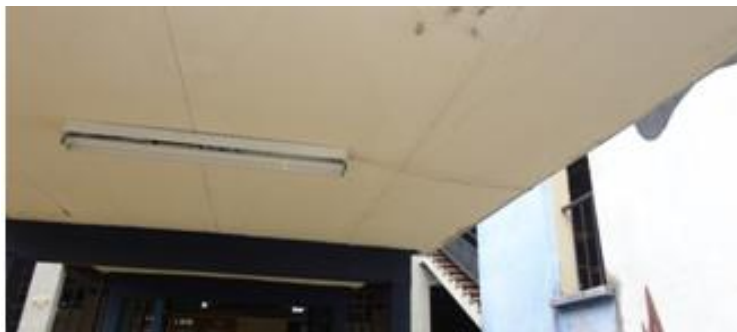
Figura 60. Lámpara en mal estado
