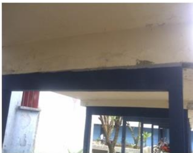
Figura 27. Techo con grietas con desprendimiento de material
