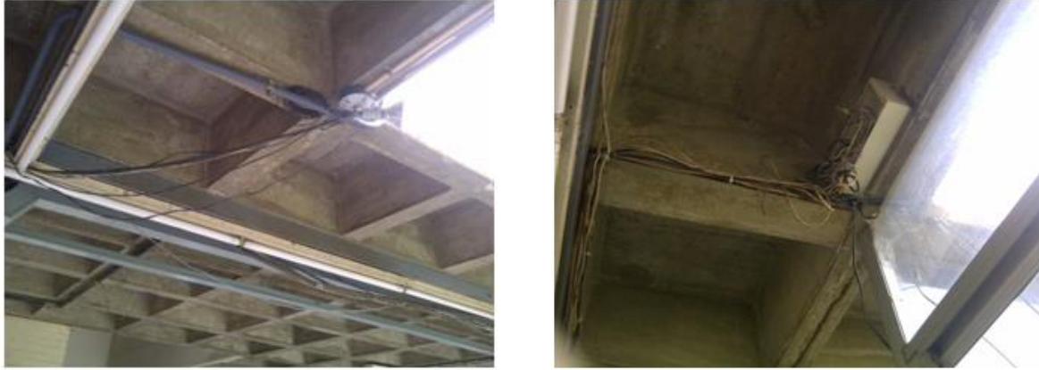
Figura 39. Cables eléctricos expuestos
