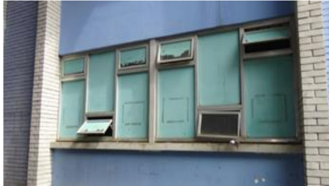
Figura 54. Ventanas con vidrios rotos
