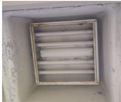
Figura 51. Lámpara dañada sin protección
