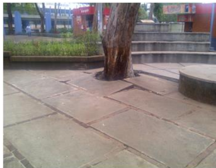
Figura 44. Grietas en el piso
