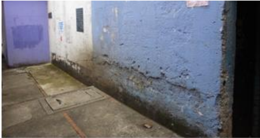
Figura 56. Deterioro de paredes y humedad
