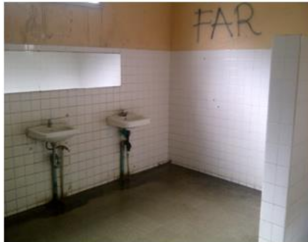
Figura 22. Lavamanos en mal estado
