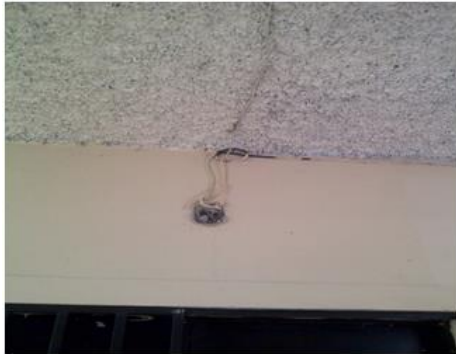
Figura 33. Cables eléctricos expuestos I
