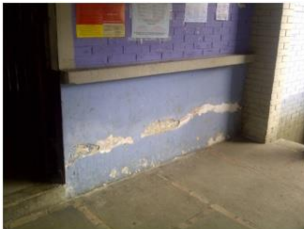
Figura 25. Pared con grietas con desprendimiento de material
