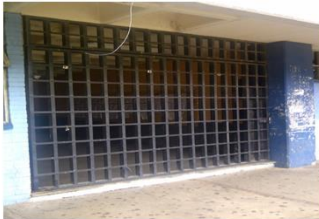
Figura 8. No hay acceso a salidas
