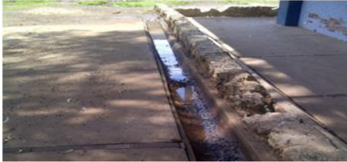
Figura 49. Canal de agua sin rejilla
