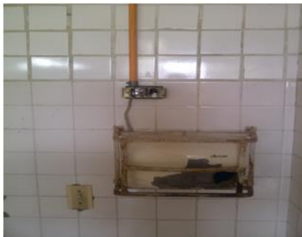
Figura 16. Secador de manos en mal estado
