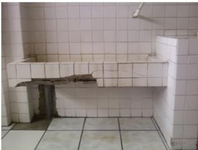
Figura 5. Mingitorios en mal estado, segundo nivel
