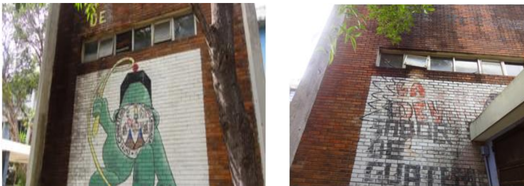
Figura 57. Filtración de líquidos en pared
