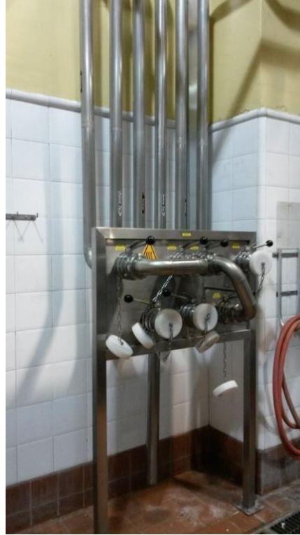
Figura 16. Panel distribuidor de tuberías
