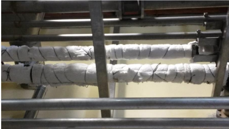
Figura 26. Tuberías de jarabe aisladas
