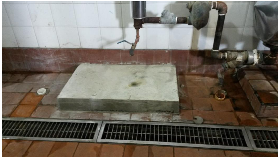
Figura 10. Plataforma de concreto para intercambiador de calor
