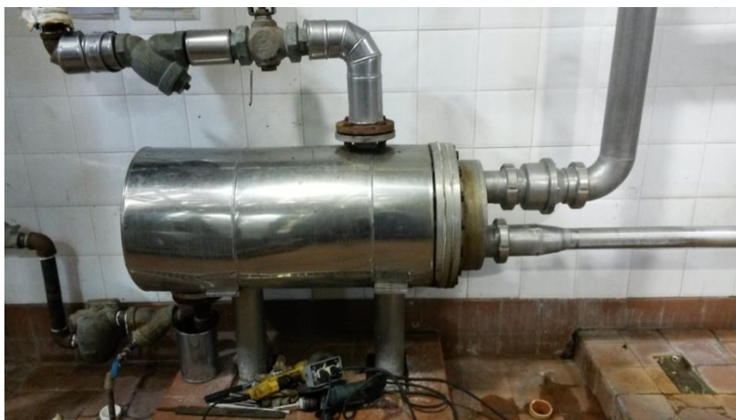
Figura 11. Intercambiador de calor reubicado
