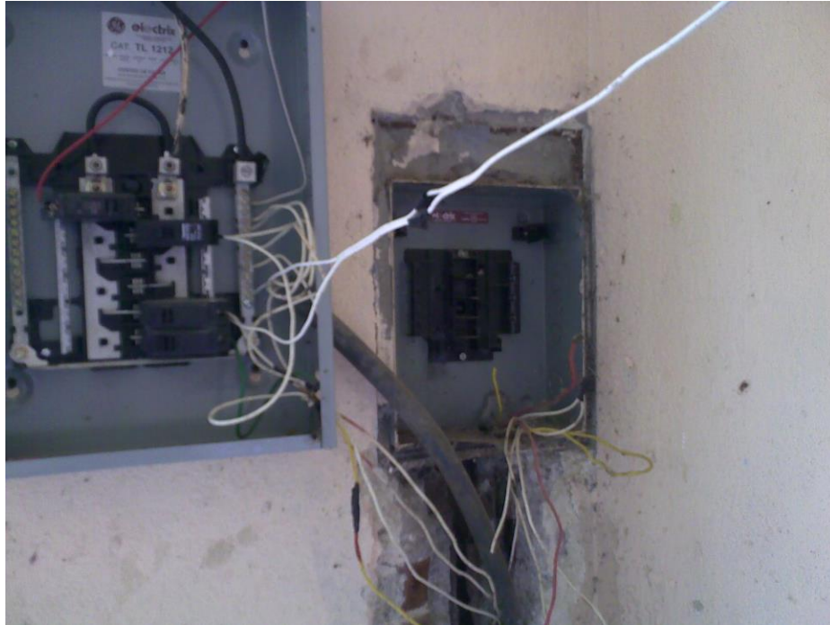
Figura 2. Entorno del tablero principal anterior
