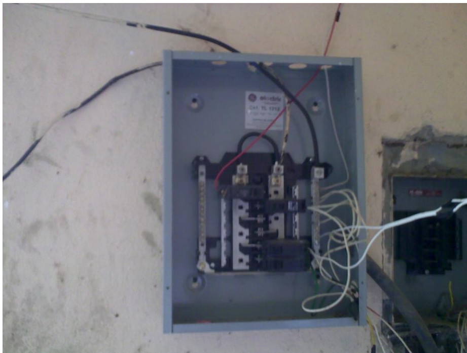
Figura 1. Instalación de tablero principal anterior
