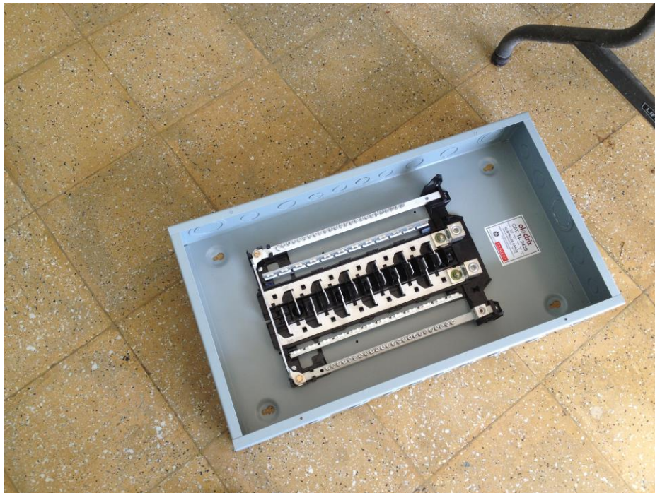
Figura 7. Tablero principal (único) nuevo
