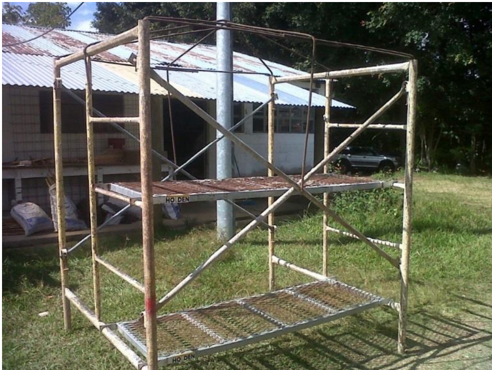
Figura 26. Armazón de la cámara de curado tipo invernadero
