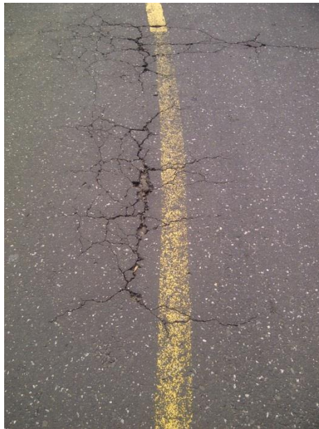
Figura 9. Fisura en bloque
