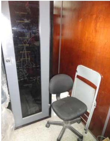
Figura 95. Uso de la Sala de Telecomunicaciones
