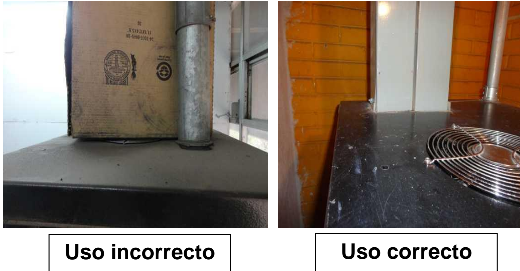
Figura 96. Cuidado de los gabinetes de telecomunicaciones
