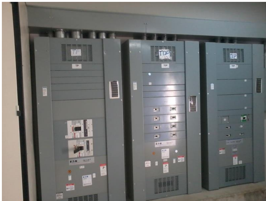
Figura 65. Tableros principales instalados en Larrsa
