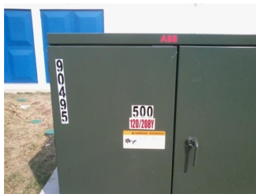
Figura 63. Fotografía de Pad Mounted de 500KVA instalado en Larrsa
