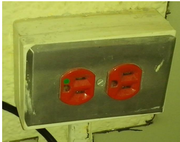
Figura 99. Tomacorriente de grado hospitalario
