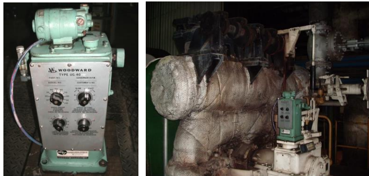
Figura 20. Gobernador Woodward instalado actualmente
