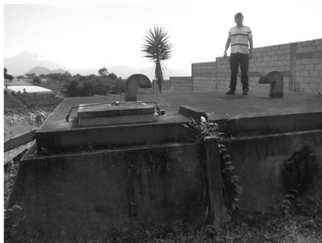
Figura 5. Tanque de almacenamiento
