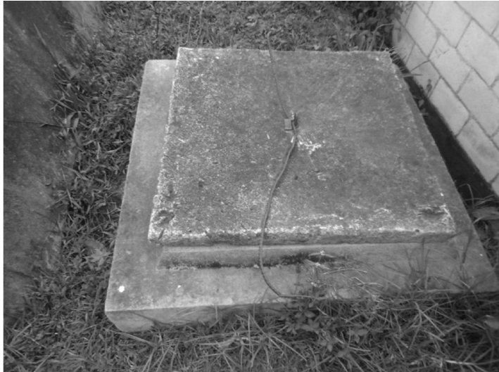
Figura 6. Depósito de cloración
