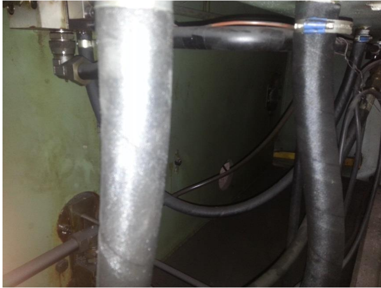
Figura 40. Mangueras de hidráulico
