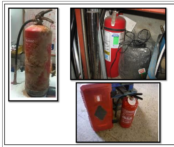
Figura 24. Ubicación actual de extintores
