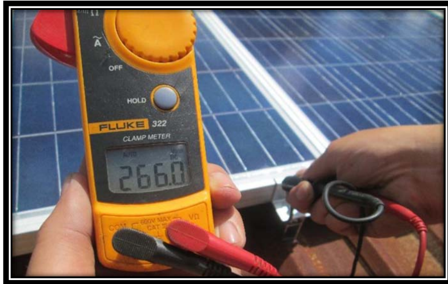
Figura 22. Verificación de niveles de tensión para la conexión de paneles solares
