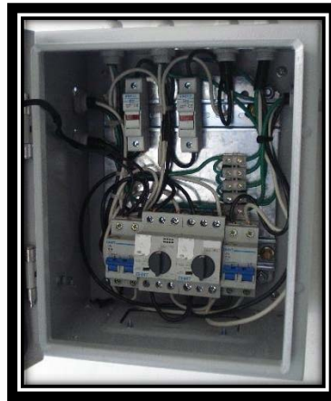
Figura 21. Cuadro de control de una instalación fotovoltaica de 5 kW p ubicada en la ciudad capital de Guatemala
