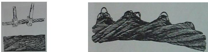
Figura 161. Estado físico del cable para respectivo cambio
