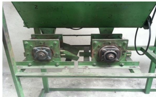
Figura 15. Vista de chumaceras tipo brida de rodillo de molienda, área de molido final
