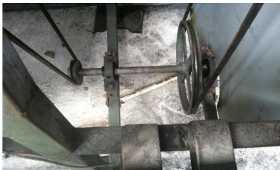
Figura 23. Vista de eje de poleas para transmisión de movimiento
