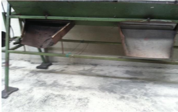
Figura 38. Vista de elementos de material elástico
