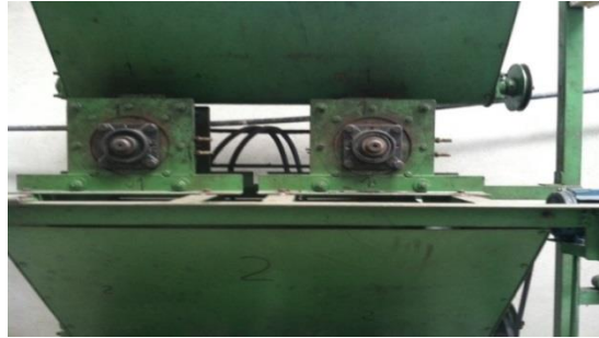
Figura 14. Vista de chumaceras tipo brida de rodillo de molienda, área de premolido
