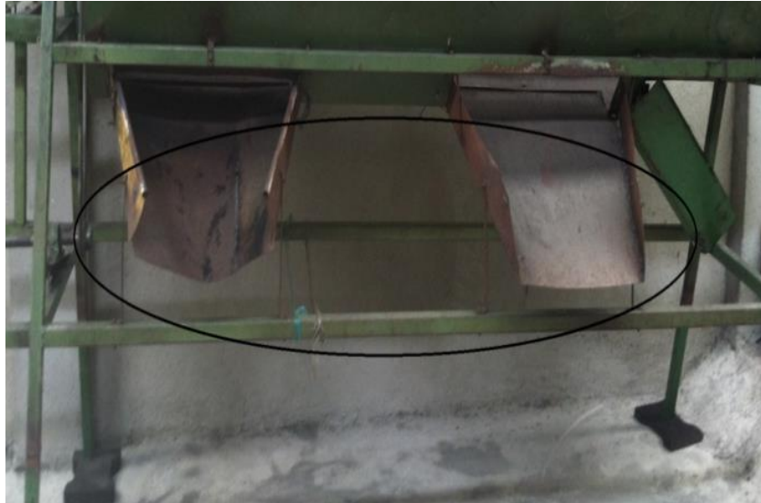
Figura 55. Factores de riesgo de estructura en criba rotativa de elección inicial, vista frontal
