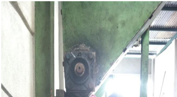
Figura 12. Vista de chumacera tipo brida de eje selector, área de premolido
