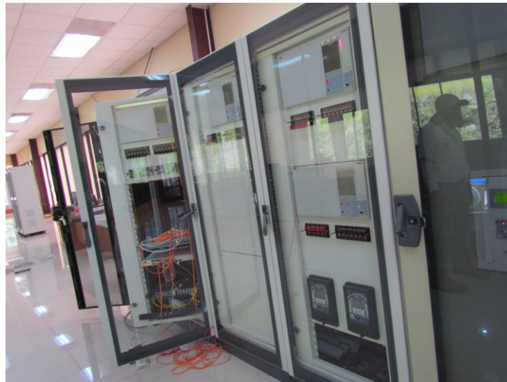
Figura 15. Centro de mando de El Manantial
