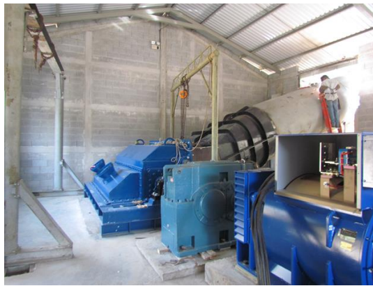
Figura 19. Generadora eléctrica La Paz
