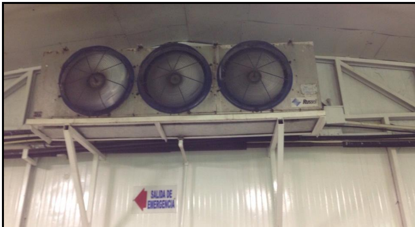
Figura 24. Vista de evaporadores interior de planta
