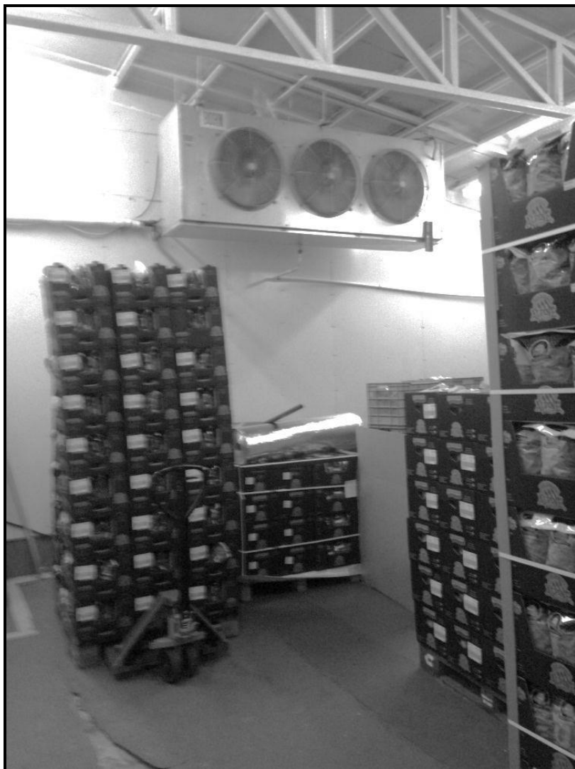
Figura 4. Vista de cuartos fríos actuales
