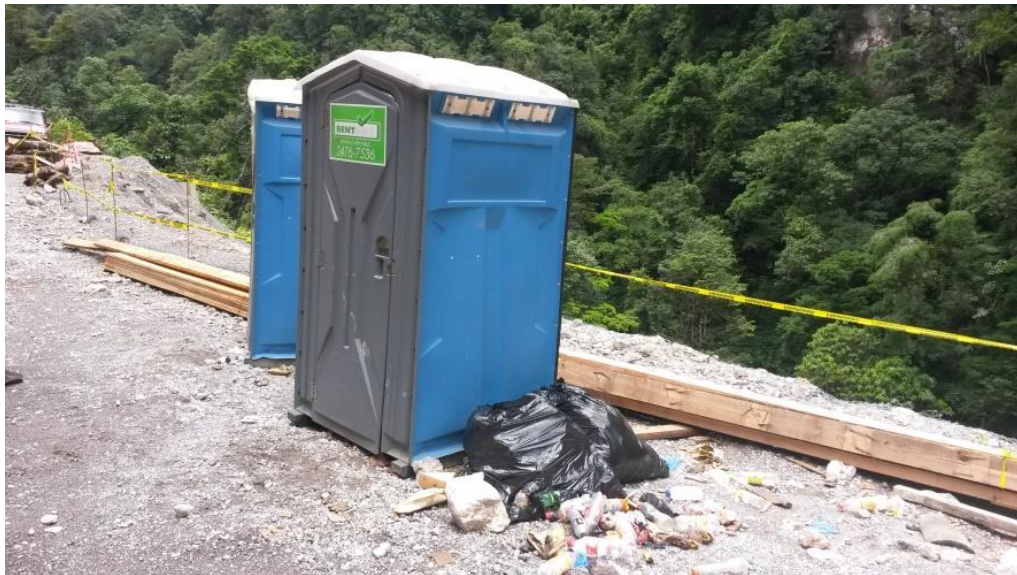
Figura 13. Baños portátiles y basura en el suelo
