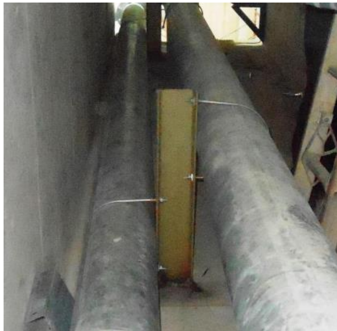
Figura 43. Soportes instalados en campo
