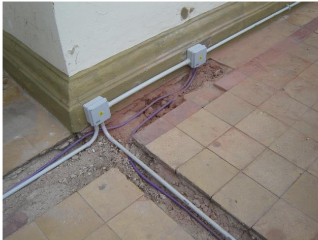
Figura 22. Instalación eléctrica expuesta
