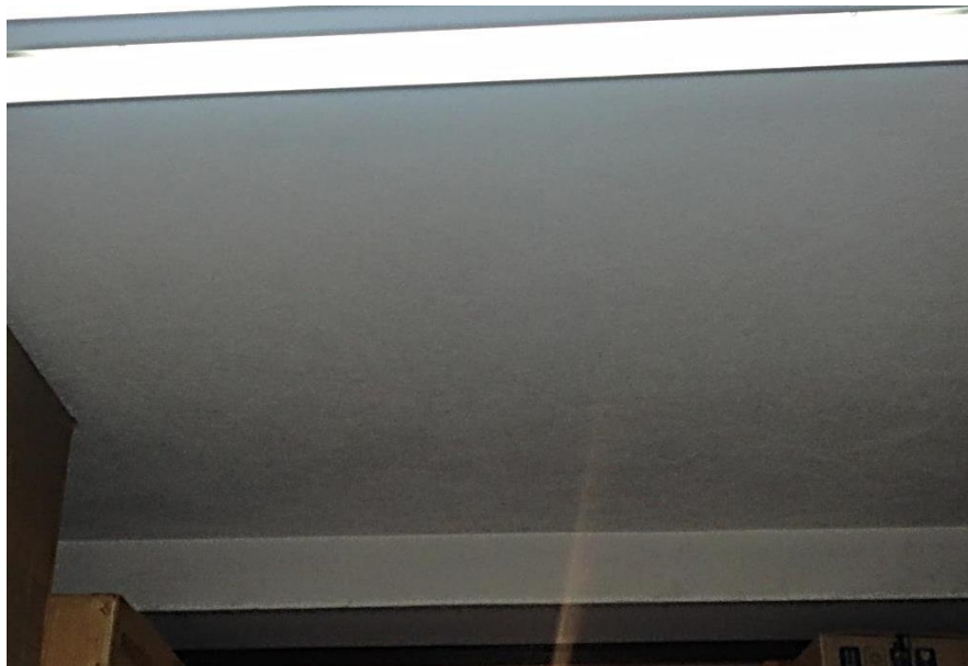
Figura 8. Estado actual del techo en bodegas y área administrativa del Departamento de Suministros
