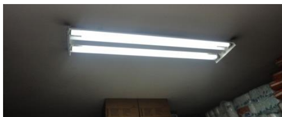
Figura 12. Luminarias actuales en el Departamento de Suministros
