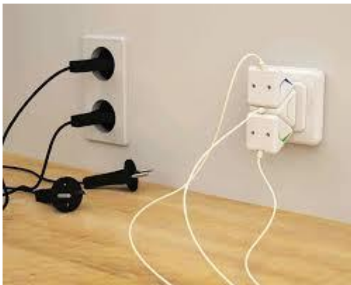
Figura 23. Instalación eléctrica no expuesta
