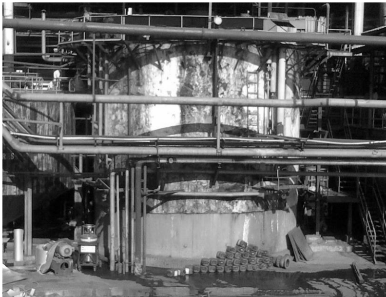
Figura 6. Clarificación, clarificador de bandeja
