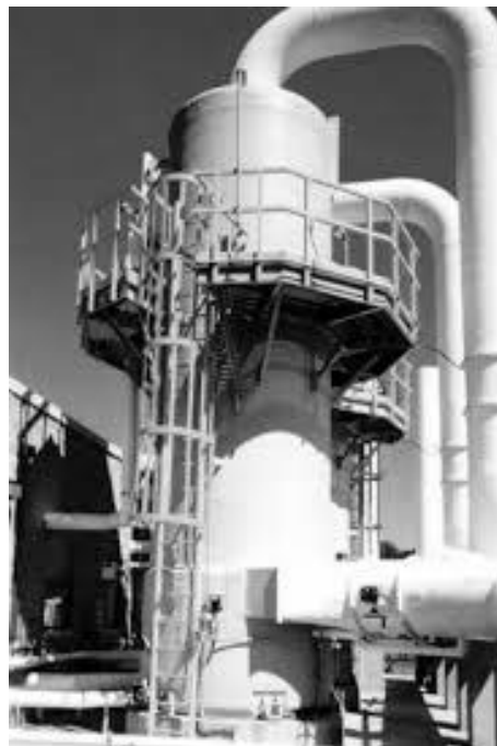
Figura 4. Sulfitación, torre de sulfatación
