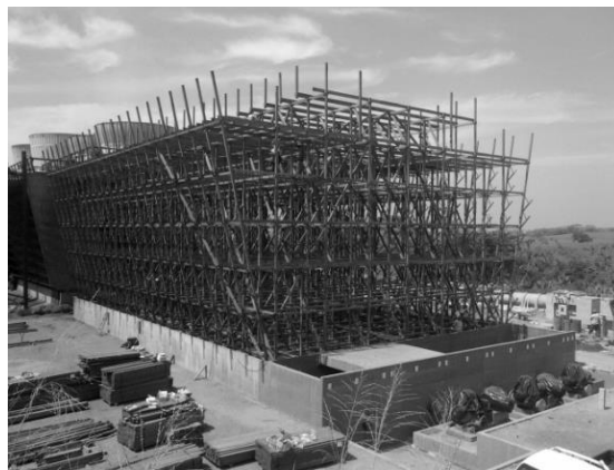
Figura 22. Estructura de torre de enfriamiento
