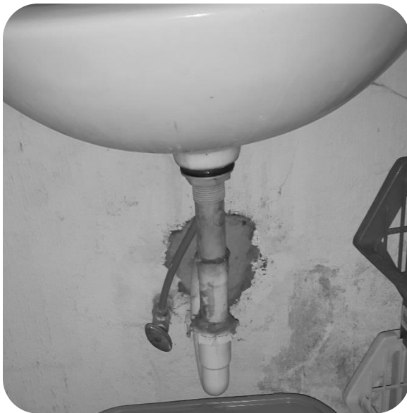
Fotografía 11 y 12. Pared deteriorada
