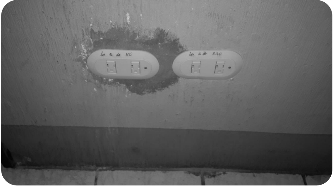
Fotografía 13. Muestra la pared deteriorada en el interior de la clínica
