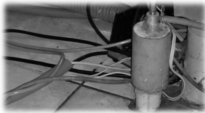
Fotografía No. 11. Se observa suciedad que provocaba el desagüe.
