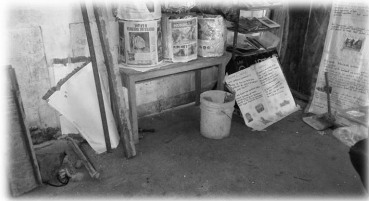
Fotografía No. 1. Interior del aula de 6to. grado de EOUM Los Almendros después de la colocación de la torta de cemento.
