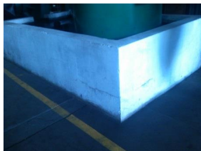
Figura 124. Pileta de retención de ceniza
