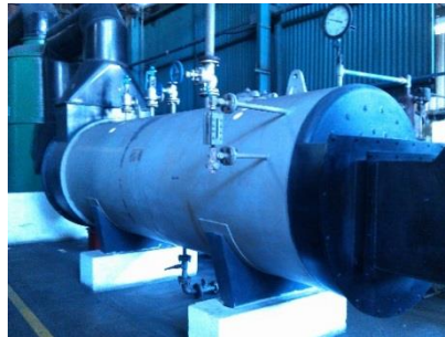
Figura 75. Generador de vapor
