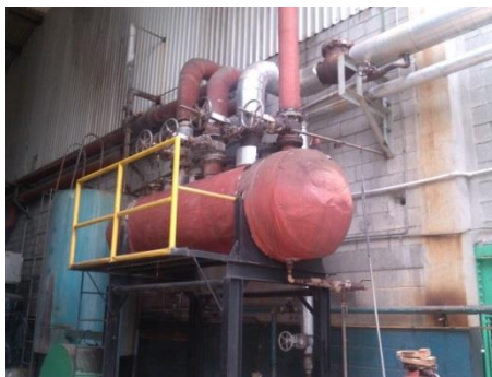
Figura 24. Manifould de distribución de vapor
