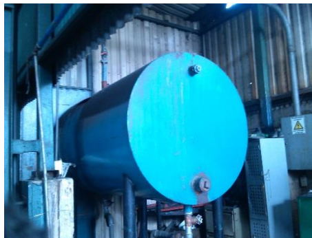
Figura 88. Tanque de agua de generador de vapor
