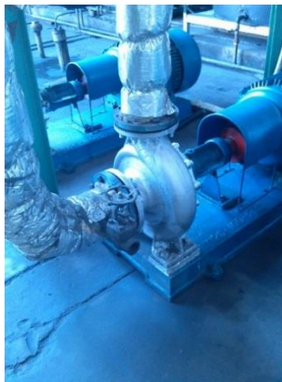
Figura 92. Bomba de aceite térmico
