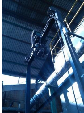
Figura 83. Motorreductor de elevador de tolva
