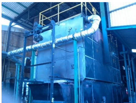
Figura 74. Intercambiador de calor
