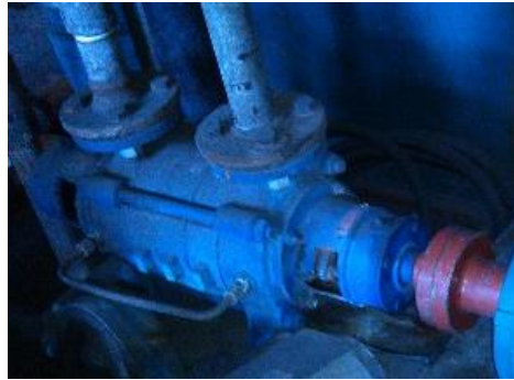
Figura 93. Bombas de agua
