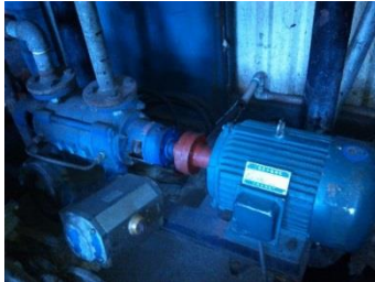
Figura 79. Motor de bomba de agua
