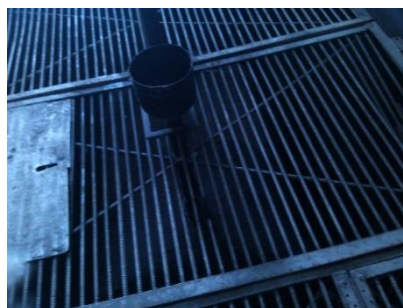
Figura 87. Tanque de almacenamiento
