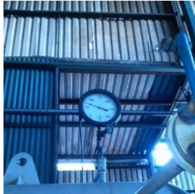
Figura 90. Manómetro del generador de vapor
