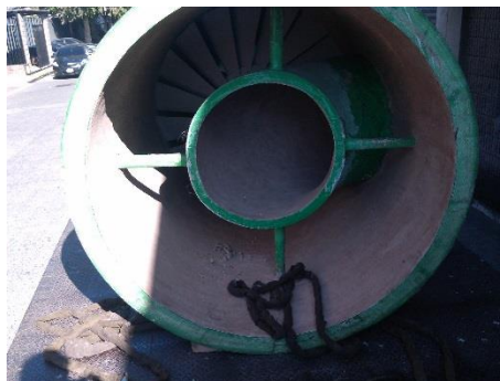
Figura 126. Interior del separador ciclónico de ceniza
