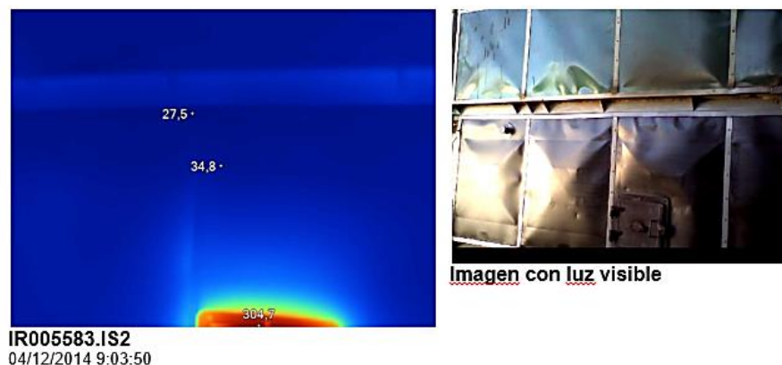
Figura 123. Termografía al horno de la caldera (después)
