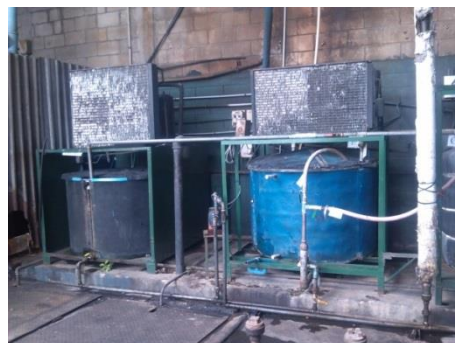
Figura 27. Chillers de agua fría
