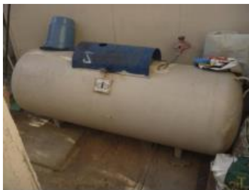
Figura 17. Tanque de gas propano que alimenta las freidoras
