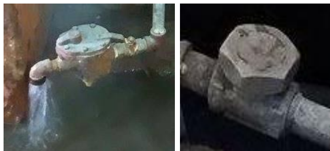
Figura 32. Trampas de vapor núm. 8 y núm. 3
