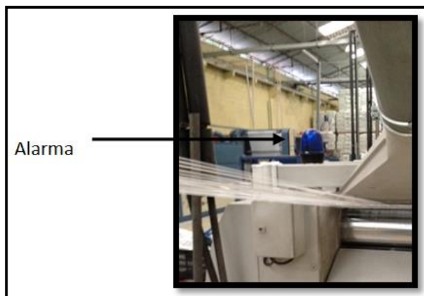
Figura 13. Alarma de corte
