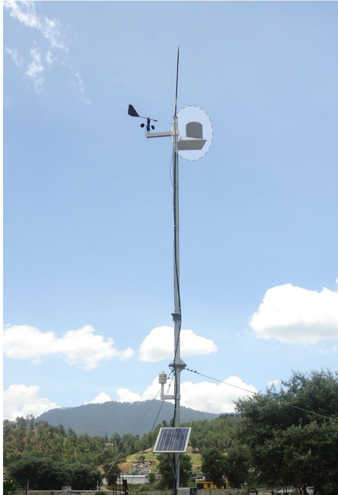
Figura 19. Pluviómetro estación telemétrica satelital
