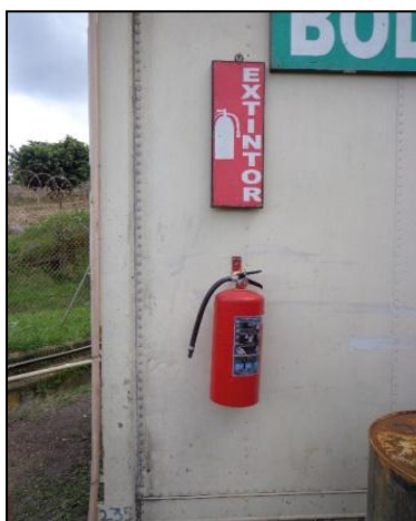
Figura 26. Señalización de extinguidores en área de lavado
