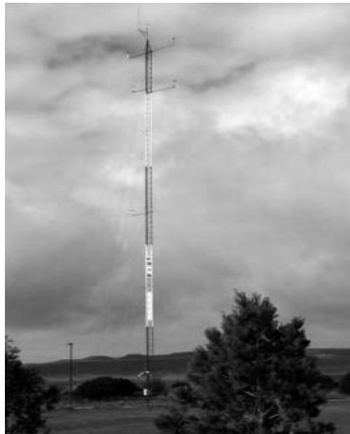
Figura 9. Torre de celosía de 30 metros de altura
