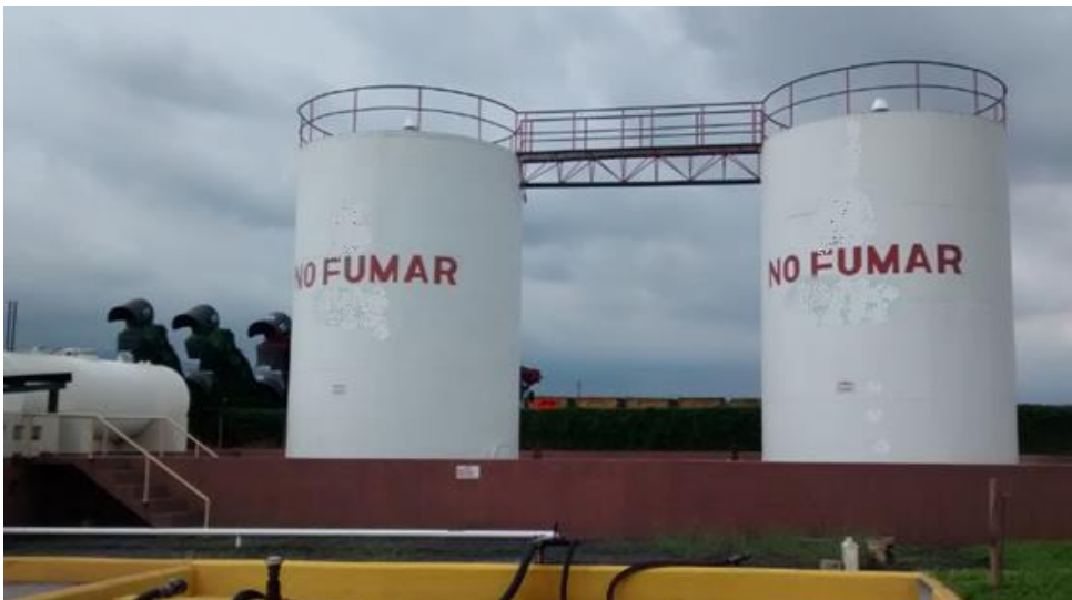
Figura 4. Tanque cilíndrico vertical
