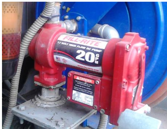
Figura 10. Bomba de despacho de combustible marca Fill-Rite alimentada por acumulador 12 V
