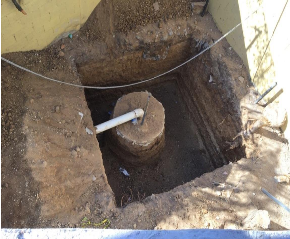
Figura 6. Fosa séptica utilizada en la fábrica
