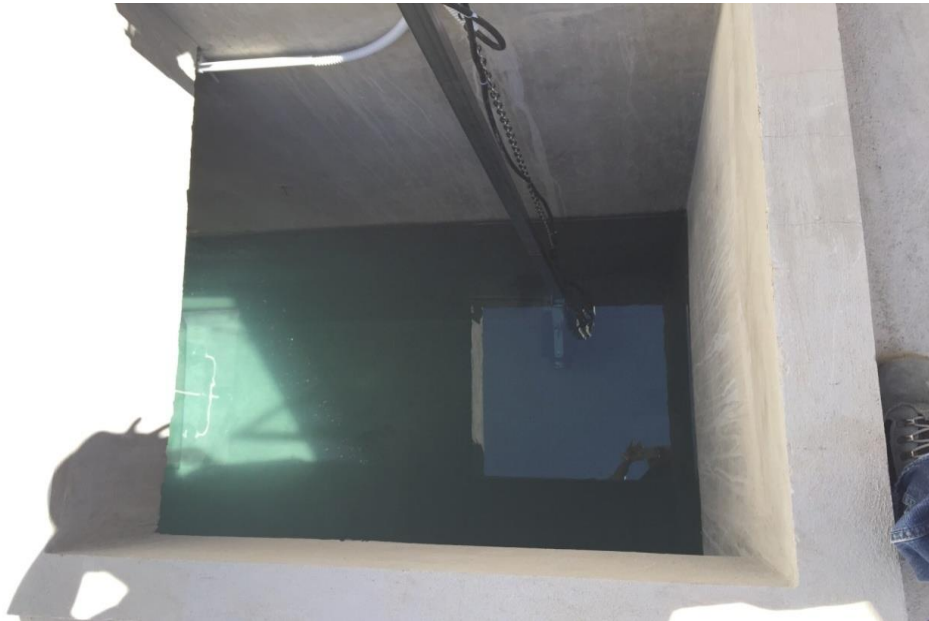
Figura 10. Laguna de estabilización
